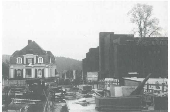
Dunkel wuchtet das neue Fernmeldeamt der Post an der Goebenstraße („Kaaba von Gummersbach“). Links das Haus Kohlgrüber (jetzt Brensing), vorn die Baustelle Bismarckplatz.
